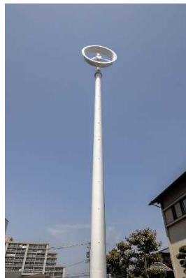
風力発電設備※
