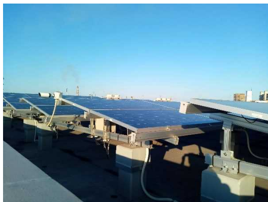
太陽光発電設備
