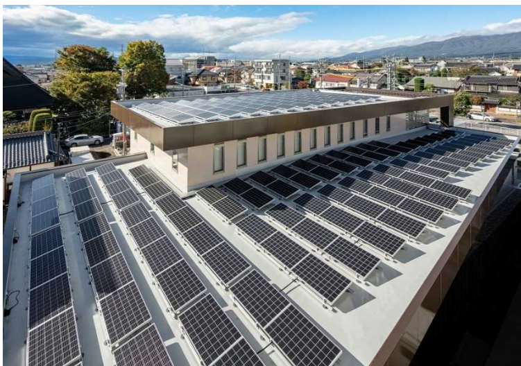
太陽光発電設備
