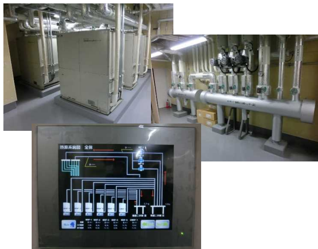
地中熱ヒートポンプ空調
