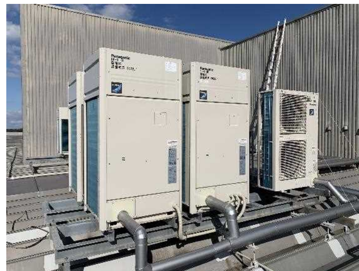
高効率空調 室外機
