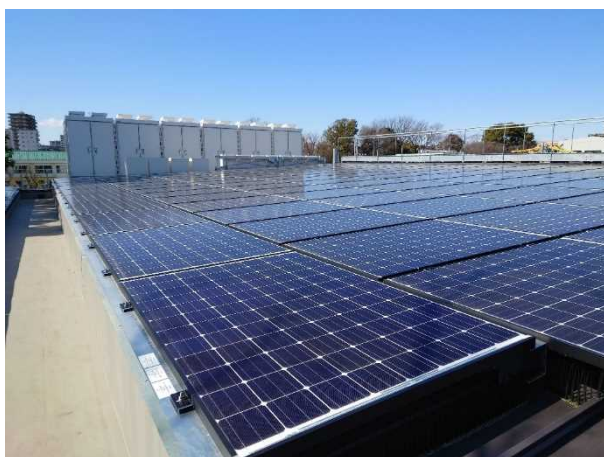
太陽光発電設備
