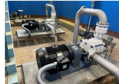
高効率ポンプ (野畑中継ポンプ場)
