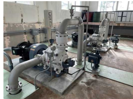
高効率ポンプ (先川浄水場)
