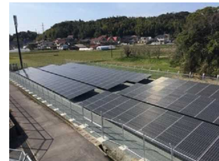
太陽光発電設備
