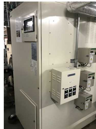
温水ボイラー
