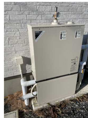
地中熱ヒートポンプ
