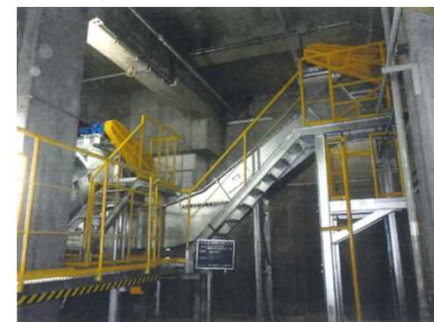
焼却残渣コンベア
