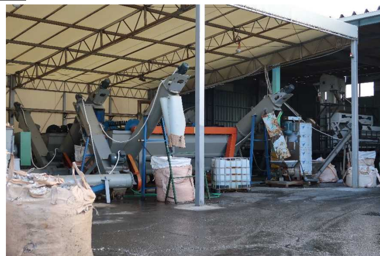
導入設備全景
