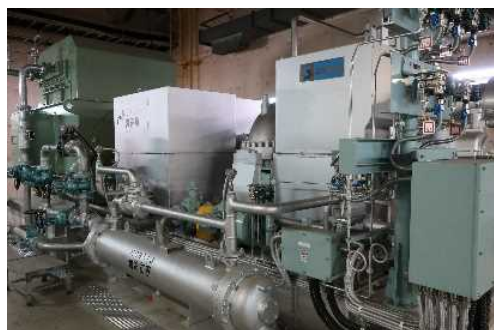
蒸気タービン・発電機
