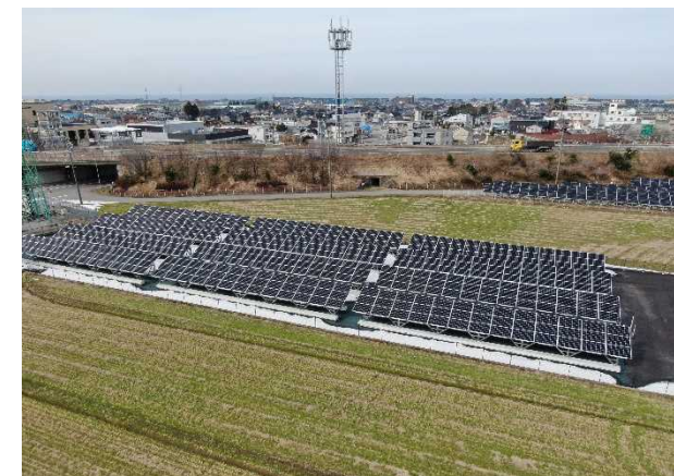
導入設備（太陽光パネル）
