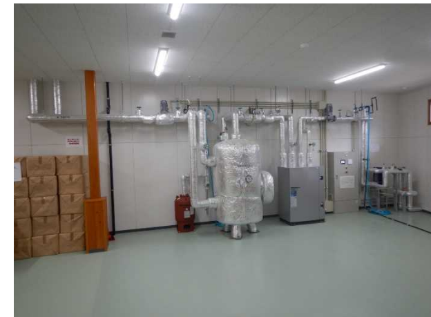
導入設備(情報施設)
