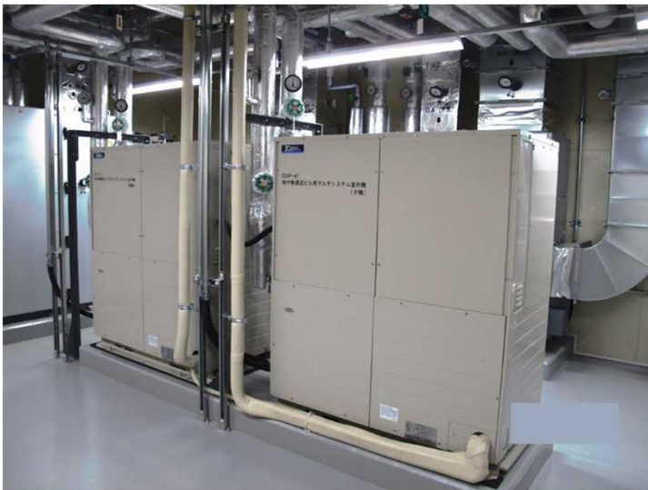
導入設備(地中熱源式ビル用マルチシステム室外機)
