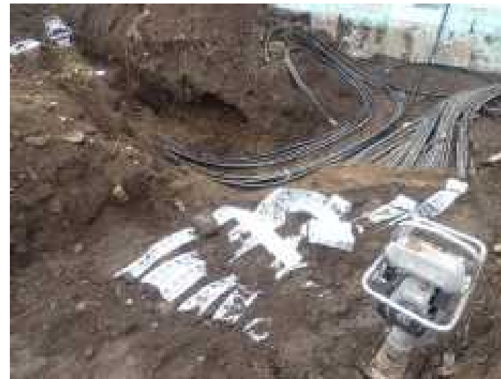
導入設備(地中熱交換器)
