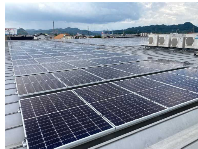
図 太陽光発電設備の写真
