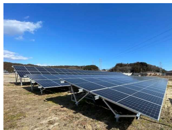
図 太陽光発電所の写真
