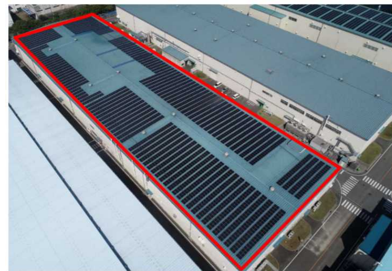
図 太陽光発電導入後の写真
