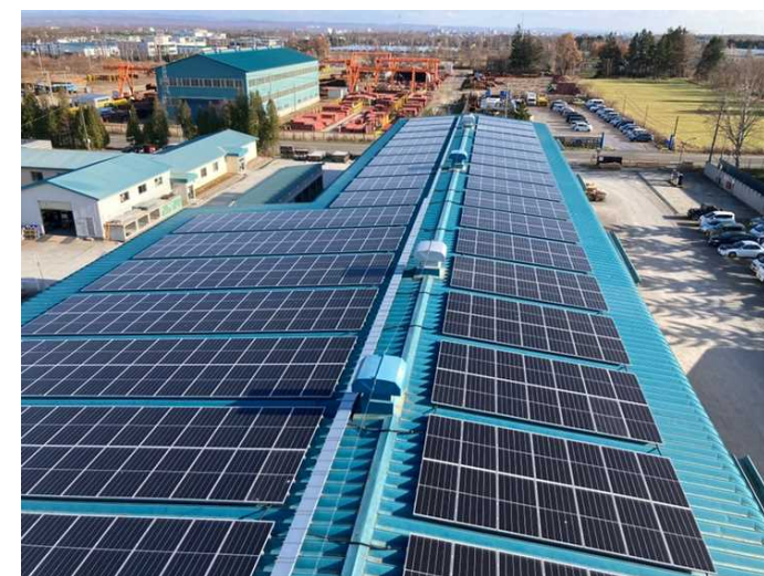
図 太陽光発電設備の写真
