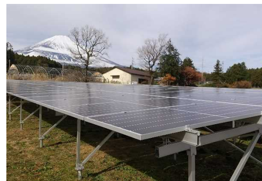
図 太陽光発電所①の写真
