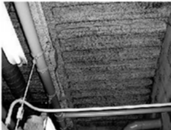
天井断熱材 天井、壁吸音材
