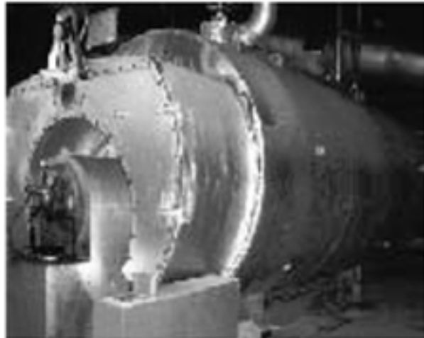
ボイラー の保温材
