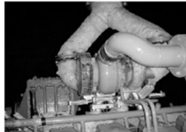
配管エル ボの保温 材②
