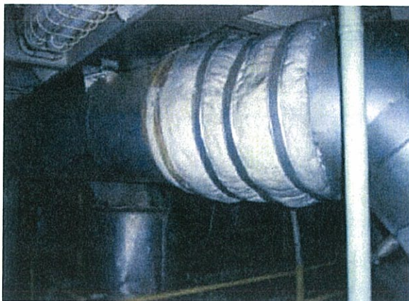
配管部分のアスベスト布団
