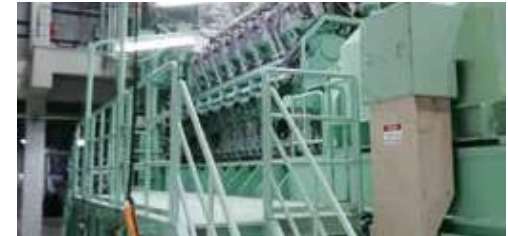
ガスコージェネレーション・冷凍機 (タイ) 関西電力
