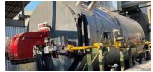
貫流ボイラー (インドネシア) DIC
