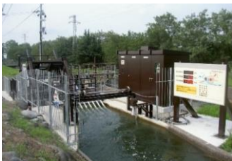
小水力発電設備 (富山県)
