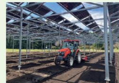
ほ場に設置された太陽光発電設備
