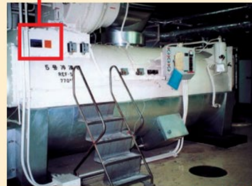
ターボ冷凍機
