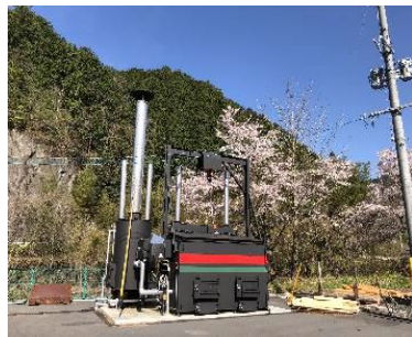
バイオマスボイラー
