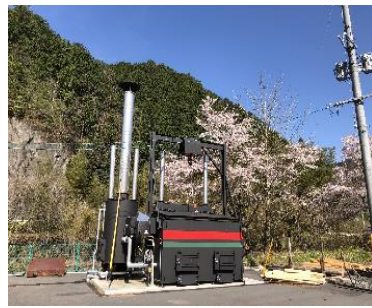
バイオマスボイラー
