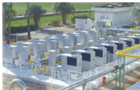
バイオガス発電施設
