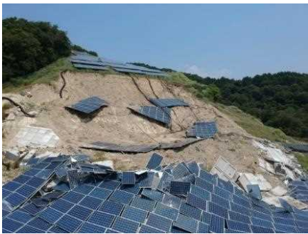
土砂崩れで生じた崩落
