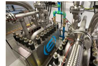
水素製造装置
