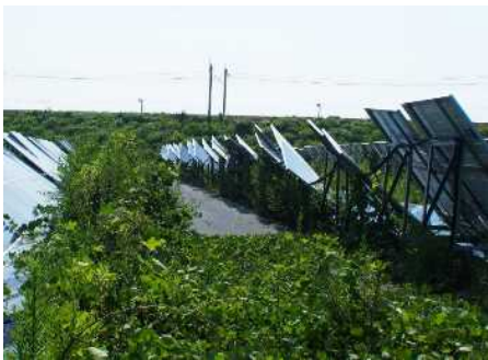
不十分な管理で放置されたパネル
