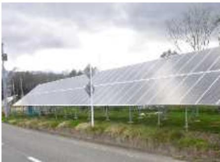
柵塀の設置されない設備
