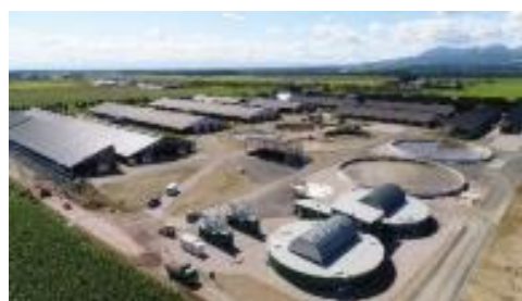
バイオガスプラント(北海道土幌町)
