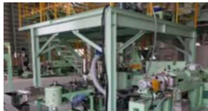
バイオマスプラスチック製造設備
