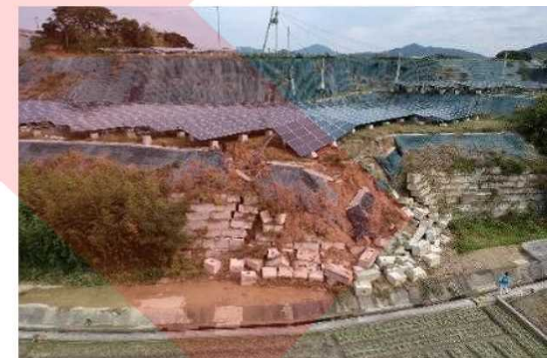
法面保護工が崩れて流出した事例
