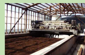
良質な堆肥を供給する 堆肥化处理施設
