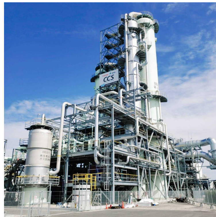
CO 2 回収実証プラント
