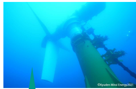
潮流発電設備
