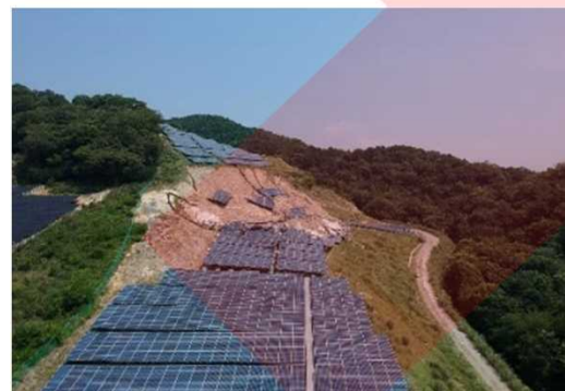
傾斜地の崩壊が発生したため、法肩部分の架台が流出した事例
