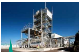
二酸化炭素分離回収設備
