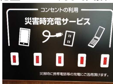
災害時に提供する充電設備
