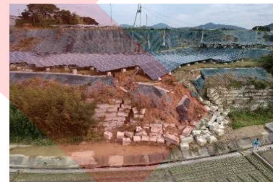
法面保護工が崩れて流出した事例
