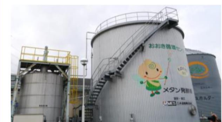
バイオガスプラント全景
