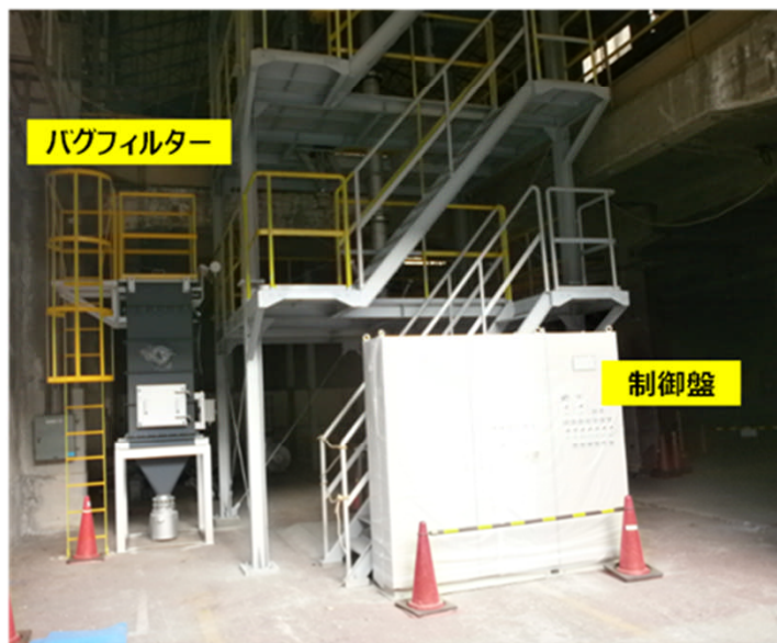
図17.架台設置後画像 (架台とバグフィルター、制御盤)
