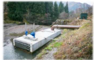
小水力発電施設
