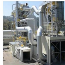
木質バイオマス発電
