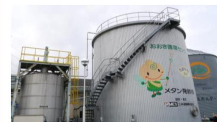
バイオガスプラント全景
