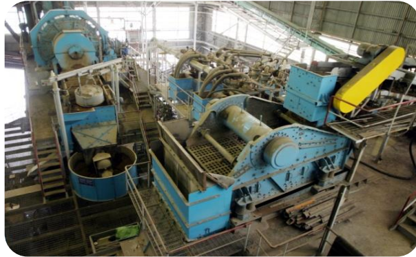
浄化等処理施設（浄化）
