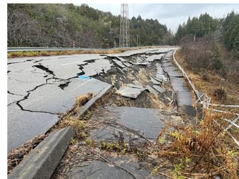
石川県七尾市 道路被害 （1月9日）
