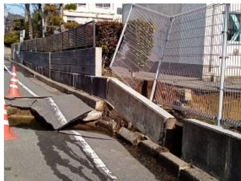
新潟県新潟市 路面の隆起 （1月2日）
