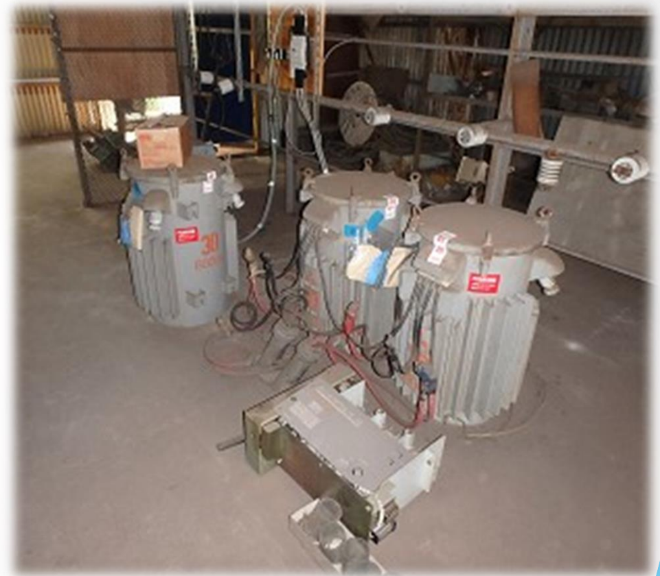
造船所の倉庫から発見された変圧器
