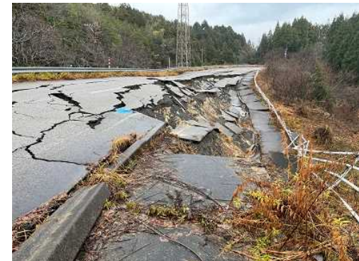
石川県七尾市 道路被害 （1月9日）
