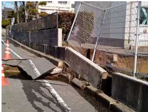
新潟県新潟市 路面の隆起 （1月2日）
