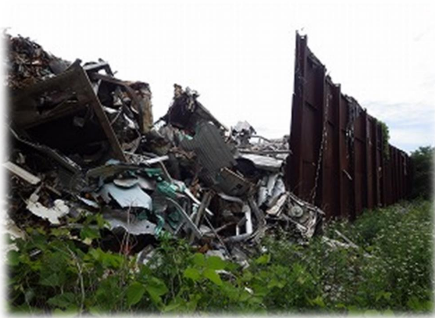
【写真】崩落した金属スクラップ
