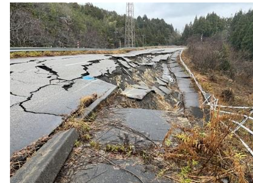
石川県七尾市 道路被害 （1月9日）
