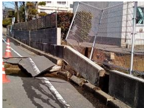
新潟県新潟市 路面の隆起 （1月2日）
