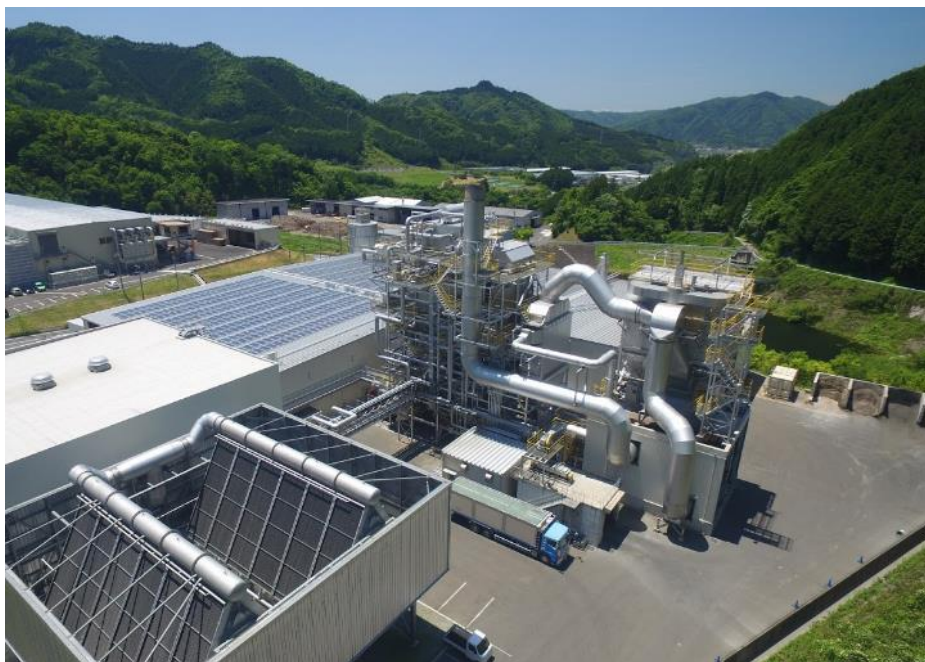
木質バイオマス発電施設の外観
