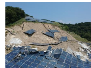
土砂崩れで生じた崩落
