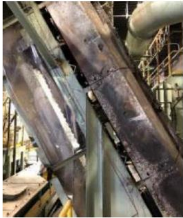
火災で焦げた破碎物コンベヤ(府中市)
