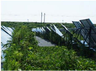
不十分な管理で放置されたパネル
