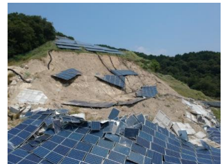
土砂崩れで生じた崩落
