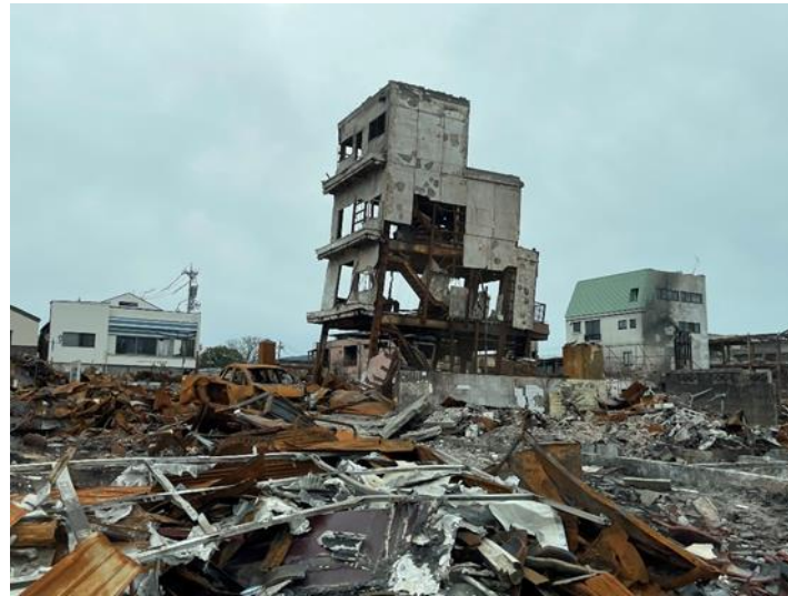
図 4-1 2024 年能登半島地震：被災現場で石綿調査を実施した石川県輪島市（2024 年 2 月）国環研撮影
