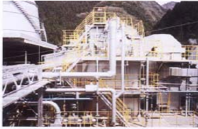
木くずだきボイラー
