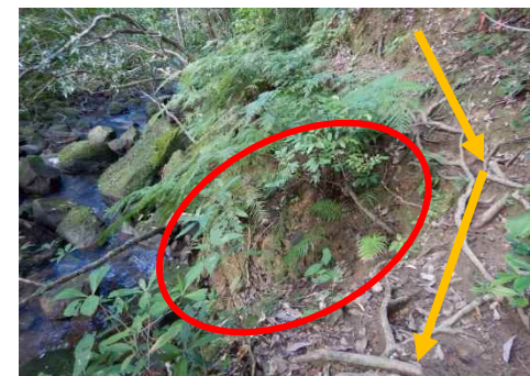
路肩がえぐれた歩道
