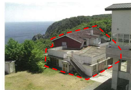
リアス式海岸の絶景への眺望を阻害している廃屋（R1年度撤去事業）
