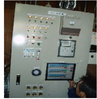
写真 6. エチレン、酸素、二酸化炭素、温度、湿度のコントロール盤
