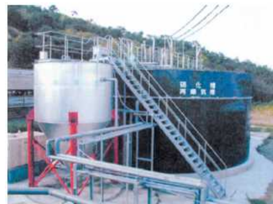
右：硝化槽、再ばっ気槽、左：沈殿槽
