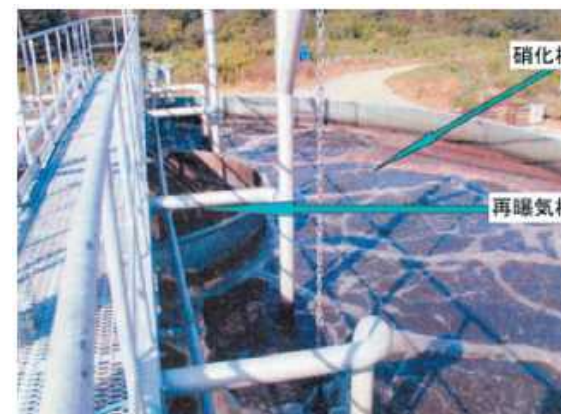
硝化槽（外周）および再ばっ気槽（中心）
