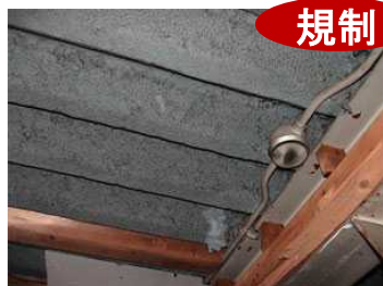
吹付けアスベスト
