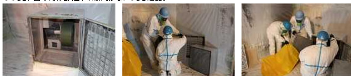
図 3.40 HEPAフィルタの交換
