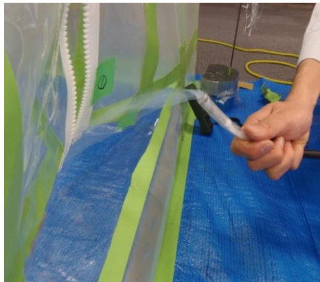
前室が負圧に保たれていることの確認例 (スモークテスターによる気流の確認)
