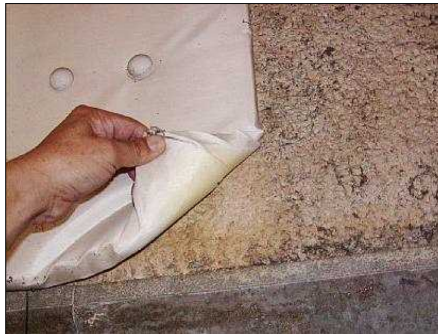
写真 1-6 機械室 グラスウール貼りの下に吹付け材の例
