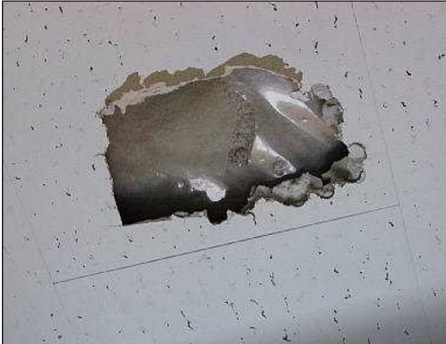
写真 1-3 商業ビル 天井石膏ボードの裏の 吹付け材でビニールで被膜されている例
