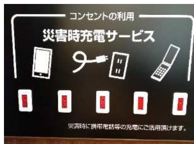
災害時に提供する充電設備
