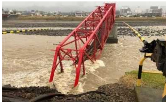
長野県上田市 橋梁が倒壊し、鉄道が不通となった。 (画像：国土交通省)
