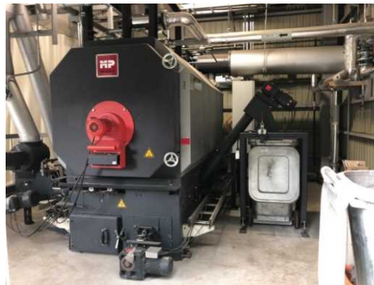
竹チップを用いたバイオマスボイラー
