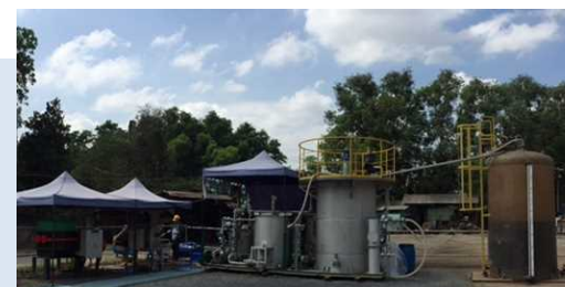
生ごみメタン発酵の実証プラント 20
