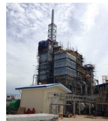
ヤンゴンにおいて竣工した廃棄物処理施設
