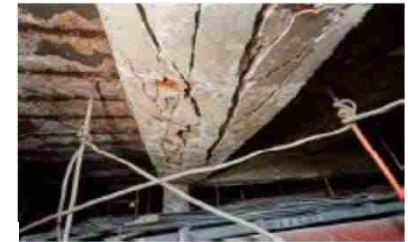
鉄筋の腐食により爆裂した コンクリート(弊所共同溝)
