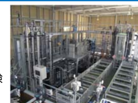
A市水道局 最適先端処理技術実験施設
